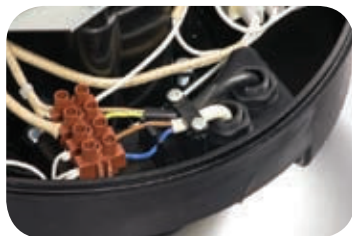
Подвод питания для рабочей и аварийной ламп.
