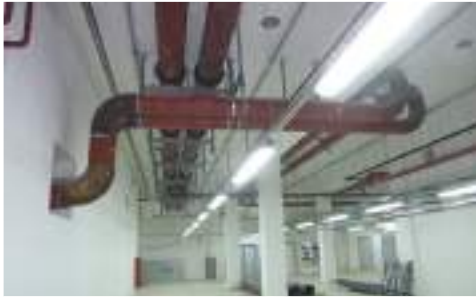
ТЕХНИЧЕСКИЕ ПОМЕЩЕНИЯ ЗАВОДА "АНГСТРЕМ" Г. ЗЕЛЕНОГРАД
